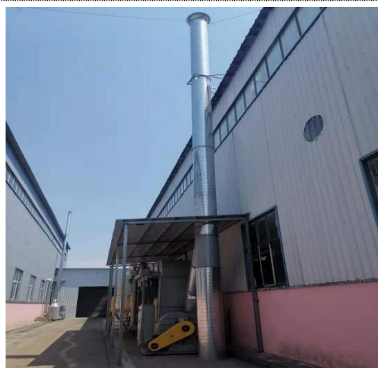
现有工程原料库和污水站废气处理设施
