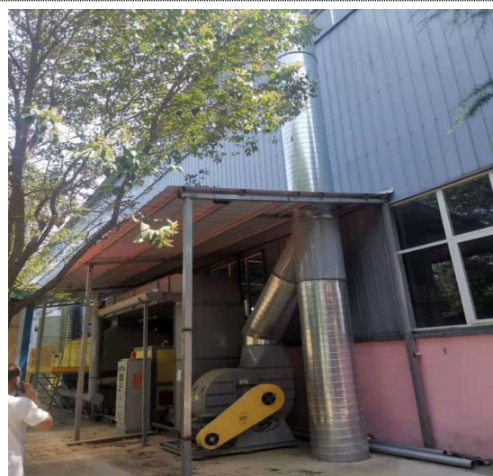
现有工程生产车间废气处理设施
