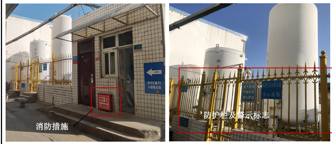
液氧储罐实景照片
