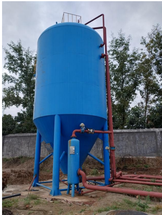
矿井水处理设施 (1)
