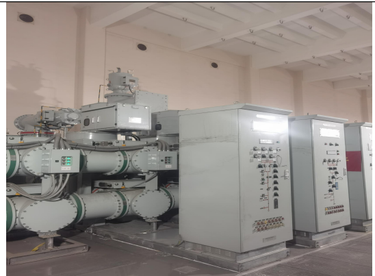
220kV 配电装置室
