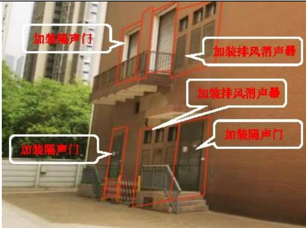
红旗 220kV 变电站南面检修门与通风口降噪措施
