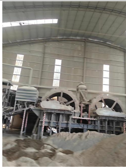
现有预处理车间集气罩及管道
