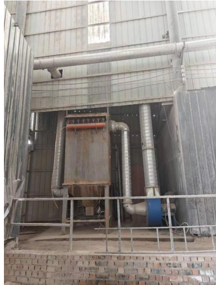
现有工程袋式除尘器及排气筒
