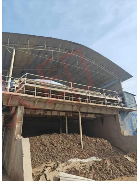
污泥暂存区及污泥压滤机
